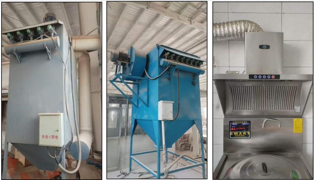
图 3-1 废气治理措施
